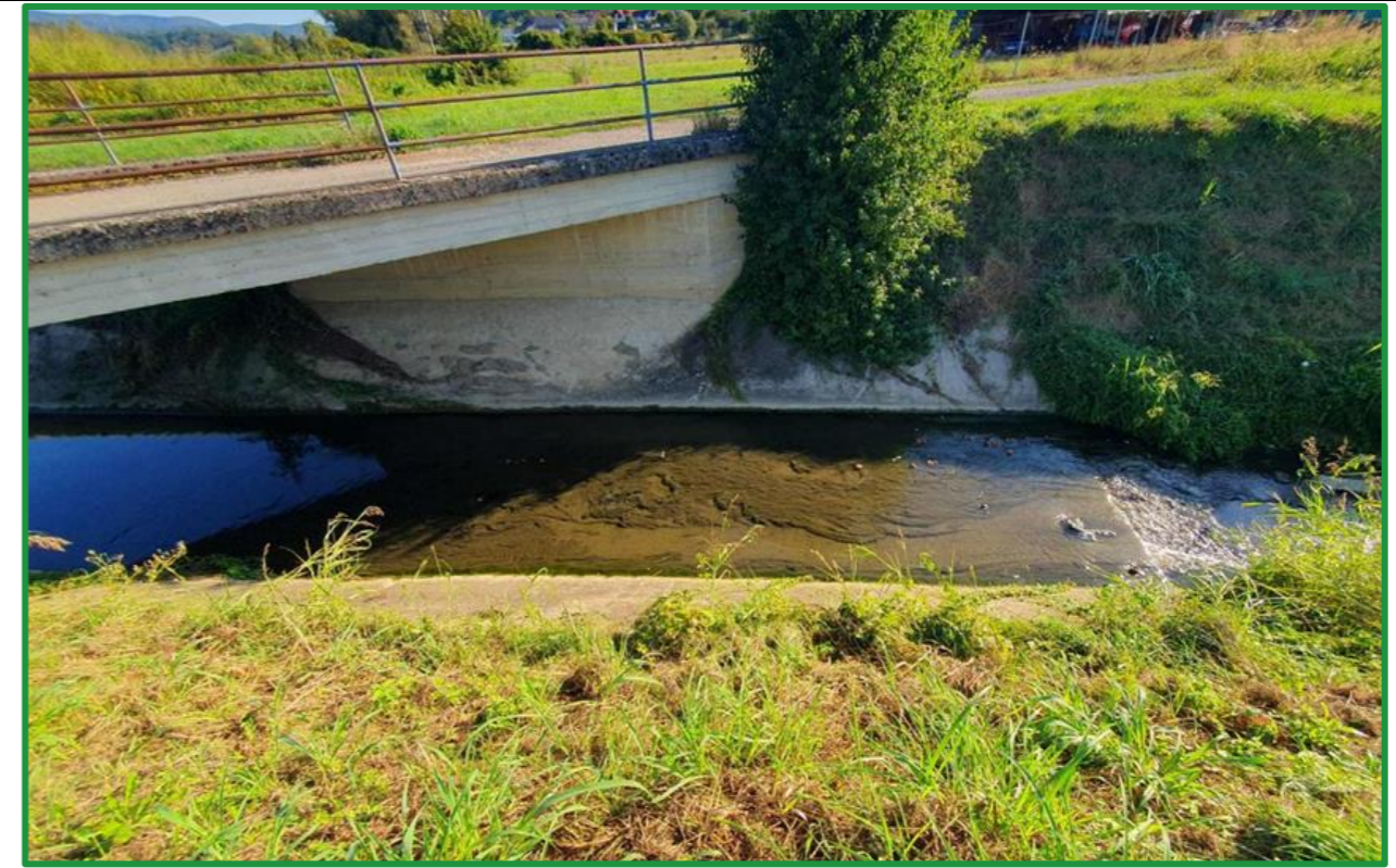
Slika 6. Potok Glavničica – slapište 1. nakon mosta (Izvor: Tau projekt d.o.o.)
