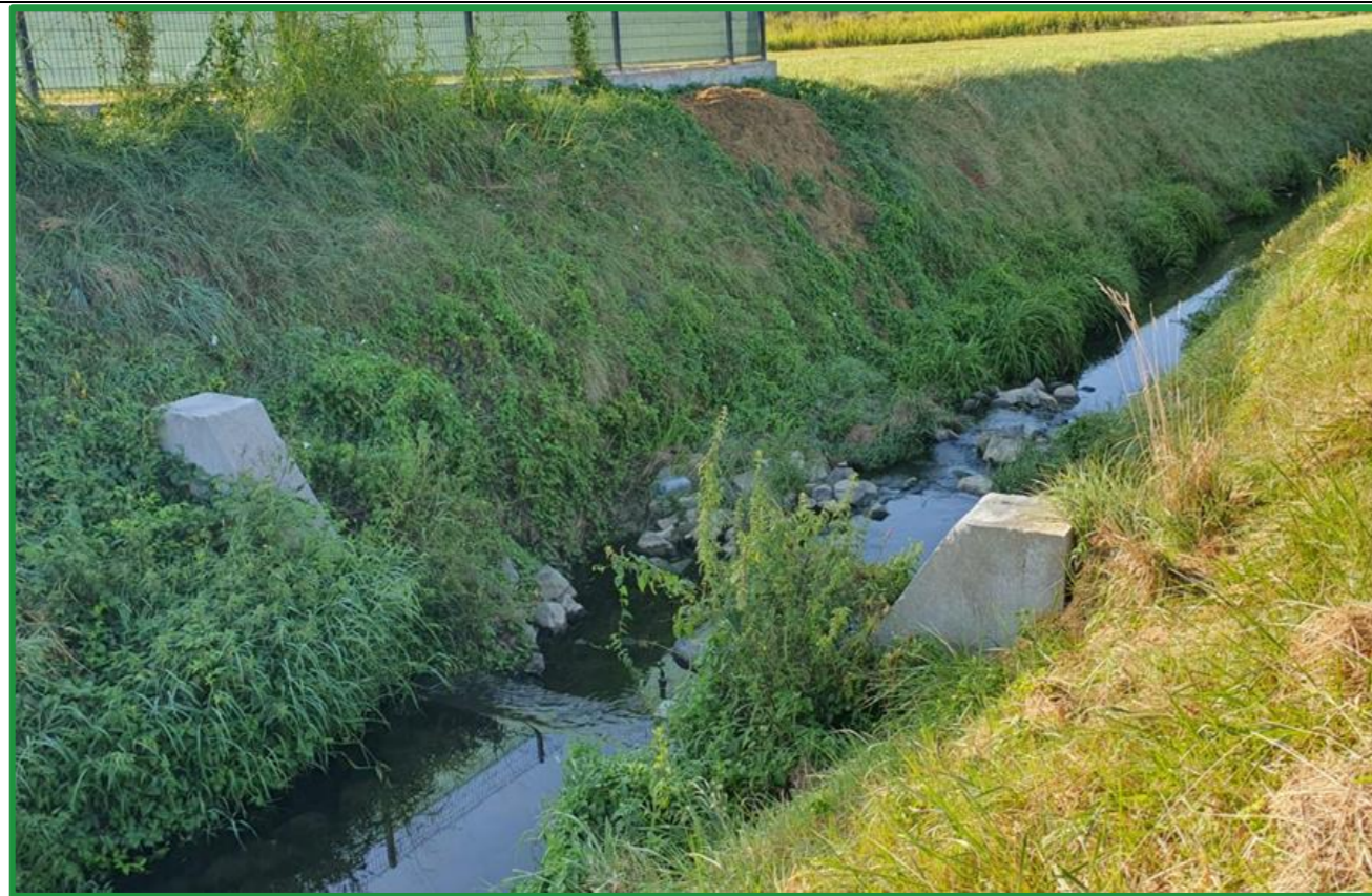
Slika 11. Potok Glavničica - stepenica 2 u km 0+406 (Izvor: Tau projekt d.o.o.)
